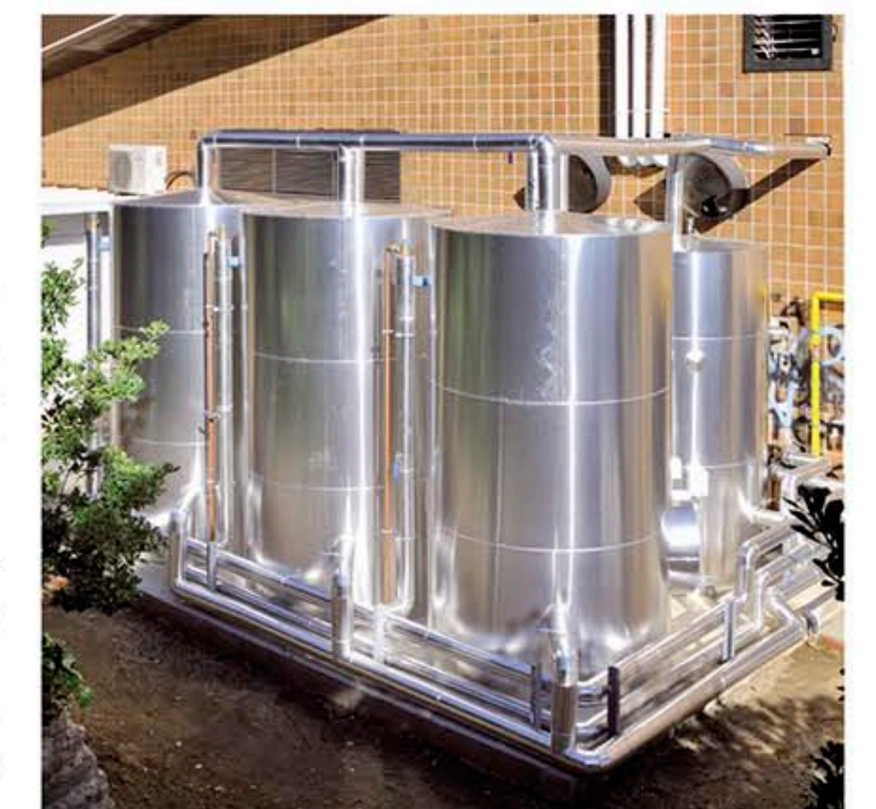
Conjunt d'acumulació per a l'aigua calenta sanitària.
